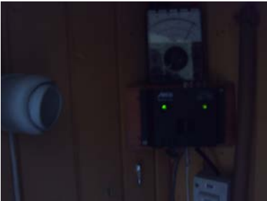
Regulator er plassert plassert i et skap på hygnerom.
