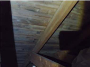
Noe misfarging på undertaket
