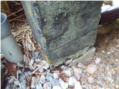
Sprekk i mellom støpt fundament og pilar av leca.
