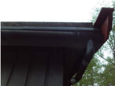
Deler av eldre slitte takrenner og nedløp.
