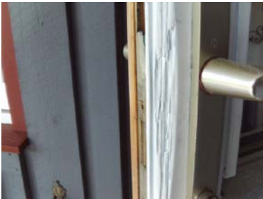
Skade på selve rammen ved låsekasse.
