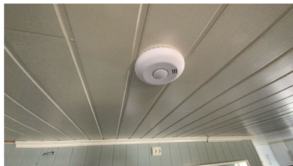
Røykvarsler i 1. Etasje
