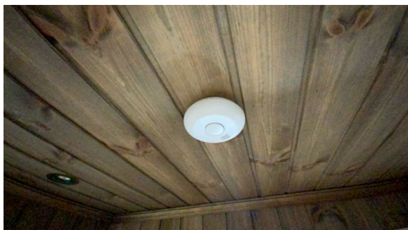
Røykvarsler i 2. Etasje
