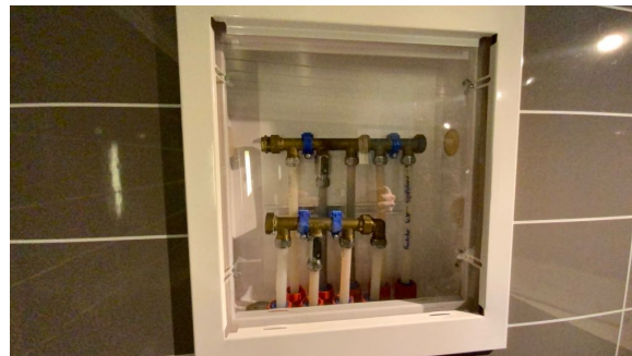
Vannskap på bad i 2. Etasje
