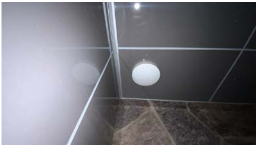
Løsning for å synliggjøre lekkasje fra vannskap.
