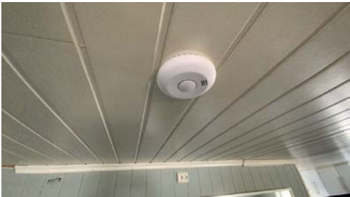
Røykvarsler i 1. Etasje
