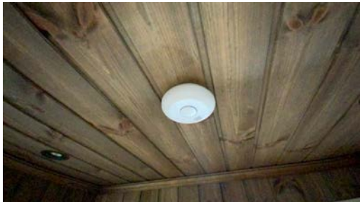
Røykvarsler i 2. Etasje
