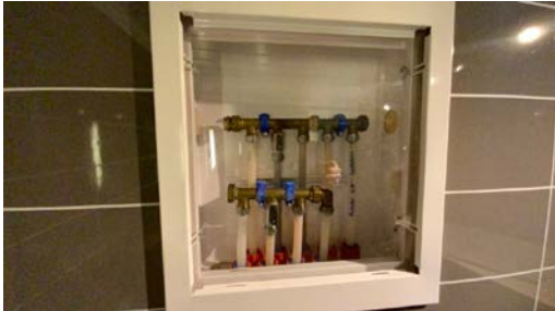
Vannskap på bad i 2. Etasje
