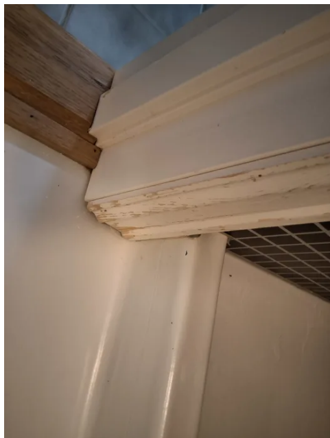
Karmlist ved dør er synlig fuktpåvirket.
