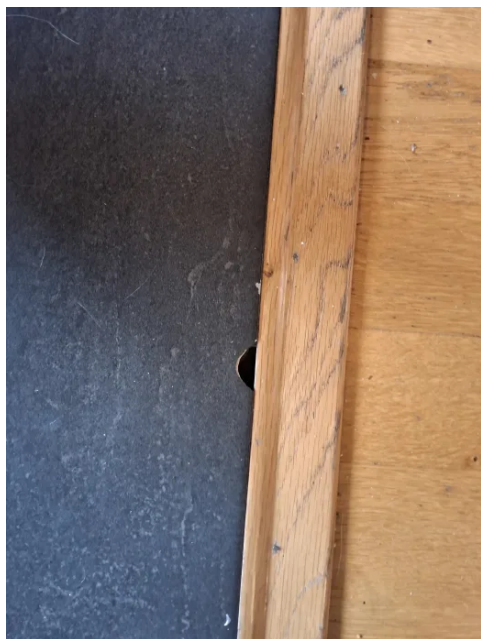
Bilde viser skadet gulvflis.
