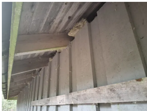
Takfoten er åpen og det spor etter at isolasjon har blitt dratt ut på veggen og bakken.
