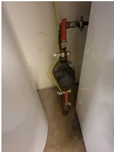
Hovedstoppekran er plassert i fyrrom.
