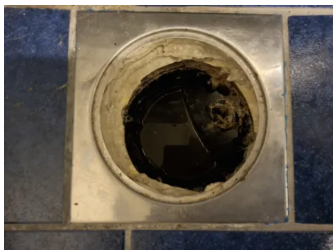
Overgang membran/sluk er uoversiktlig.
