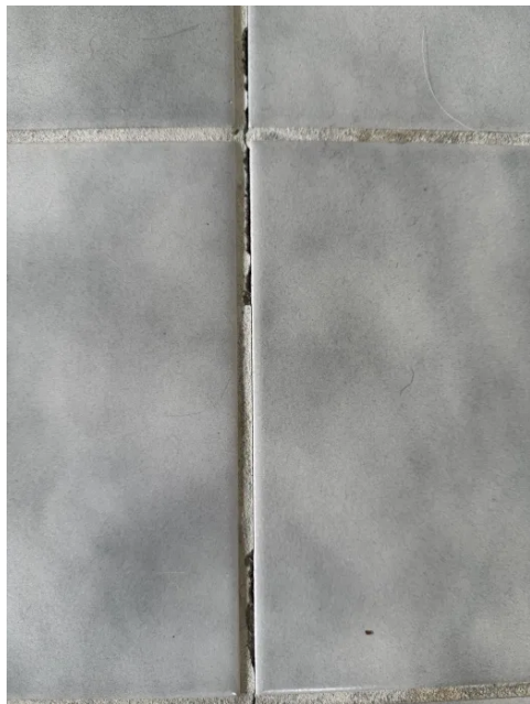
Bilde viser sprekk i flisfuger.
