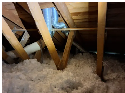
Det registreres uisolerte ventilasjonskanaler.
