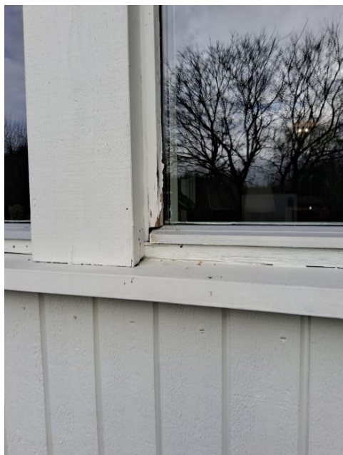
Enkelte vinduer er værslitt.
