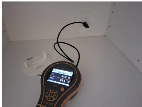
Bilde fra fuktmåling i veggkonstruksjon tilstøtende våtrommet.
