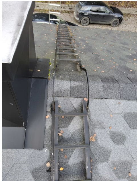
Takstigen er ikke festet til konstruksjonen.
