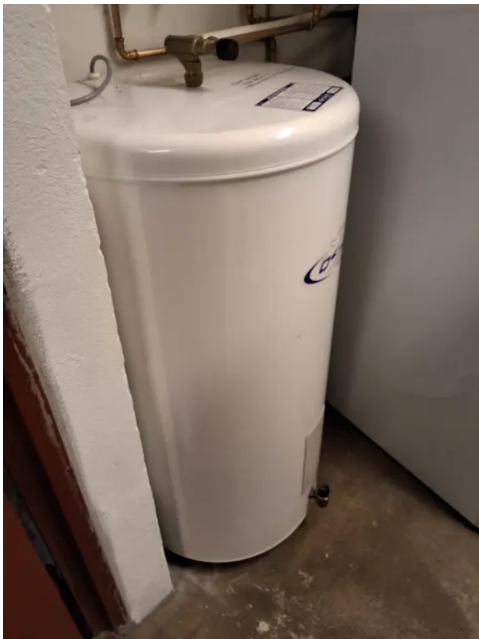
Varmtvannsbereder er plassert i fyrrom.
