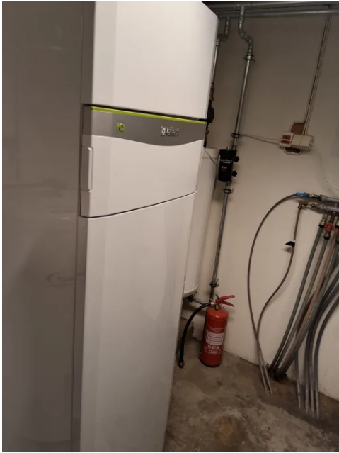
Bergvarmepumpe er plassert i fyrrom.
