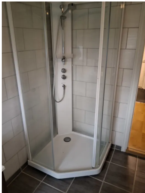
Det er etablert dusjkabinett i våtrommet.
