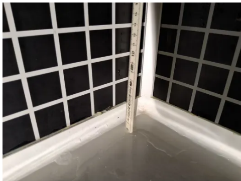
Baderomsplater er montert for nærme gulv, og det mangler stedvis tettemasse mellom sokkellist og nedre del av plate i dusjsjonen.
