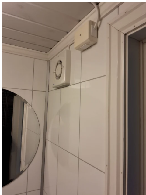
Baderomsvifte er defekt.
