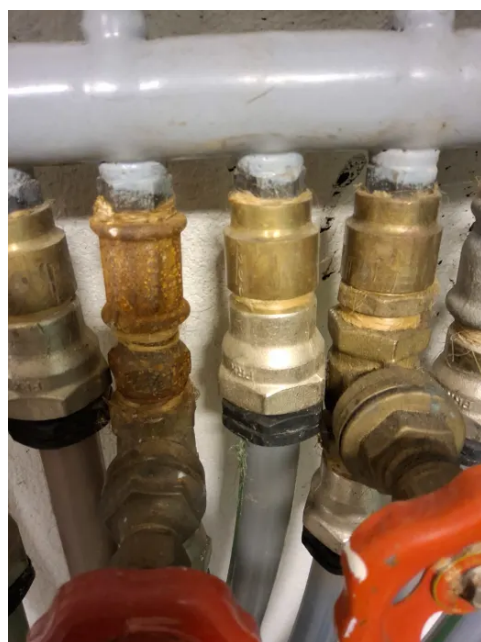
Det registreres tegn til korrosjon på enkelte rørkoblinger.
