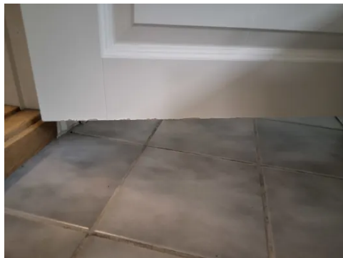
Fuktskader på nedre del av dør til våtrommet.
