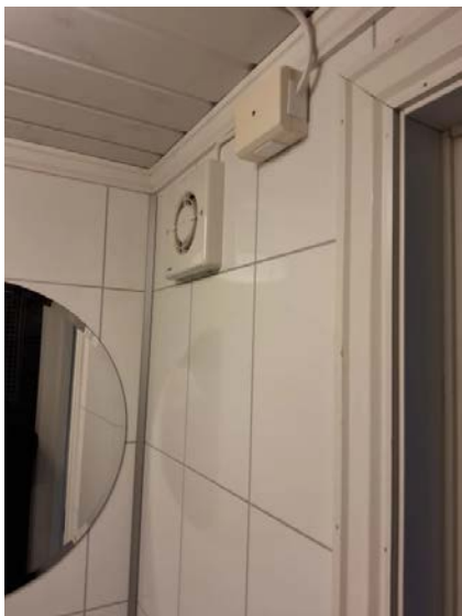
Baderomsvifte er defekt.
