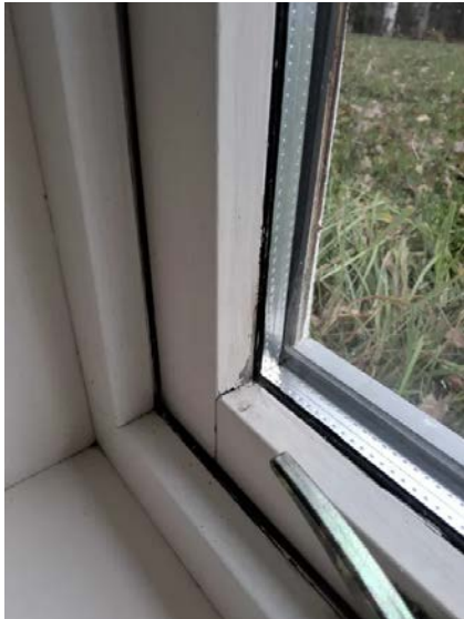
Det registreres tegn til kondensproblematikk på innsiden av enkelte vinduer.
