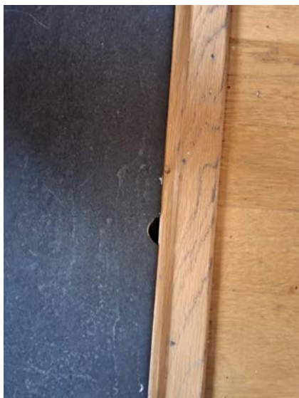
Bilde viser skadet gulvflis.
