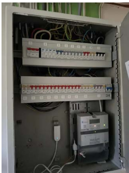
Sikringsskap er plassert i kjellerbod.
