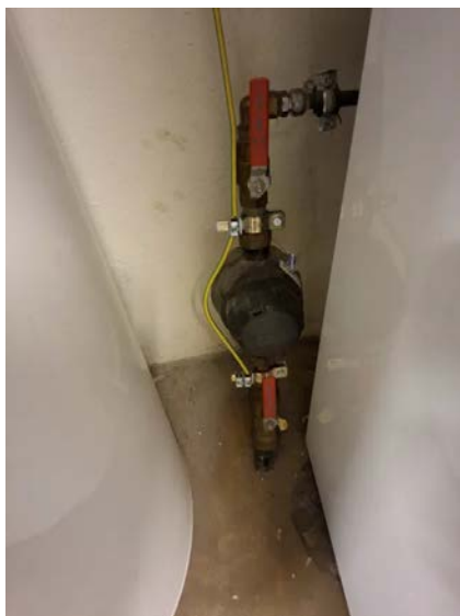
Hovedstoppekrane er plassert i fyrrom.
