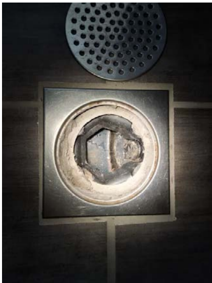
Sluk ved servantinnredning er ikke skiftet i forbindelse med oppgradering av rommet, det er ikke benyttet klemring mot membran.
