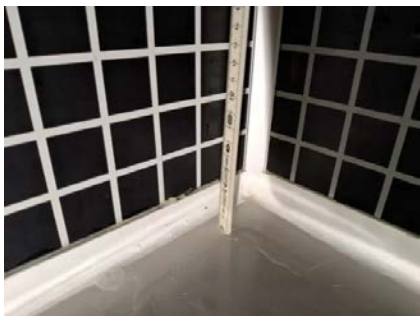
Baderomsplater er montert for nærme gulv, og det mangler stedvis tettemasse mellom sokkellist og nedre del av plate i dusjsone.
