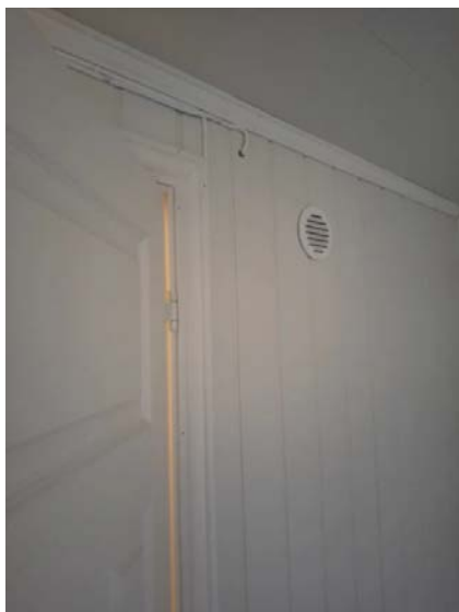
Kanal fra baderomsvifte er avsluttet med rist på soverom.
