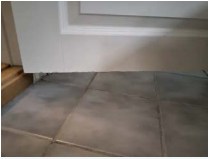
Fuktskader på nedre del av dør til våtrommet.
