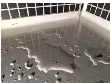
Det blir liggende vannsamlinger på gulvet i dusjsjonen.
