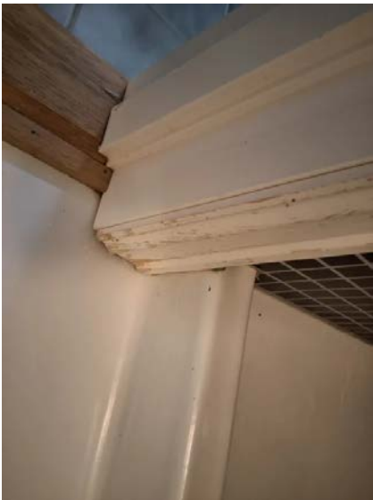
Karmlist ved dør er synlig fuktpåvirket.
