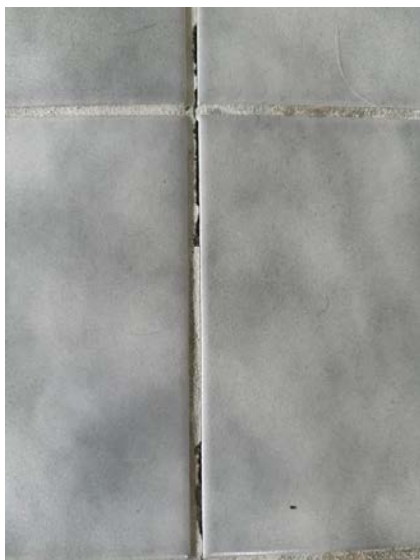
Bilde viser sprekk i flisfuger.
