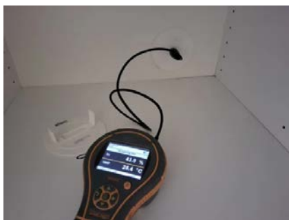
Bilde fra fuktmåling i veggkonstruksjon tilstøtende våtrommet.
