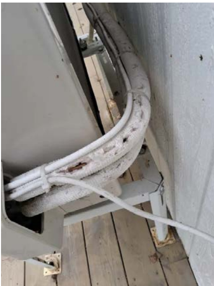
Rørisolasjon er musespist på utsiden.
