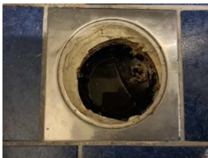
Overgang membran/sluk er uoversiktlig.
