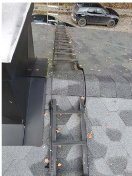
Takstigen er ikke festet til konstruksjonen.
