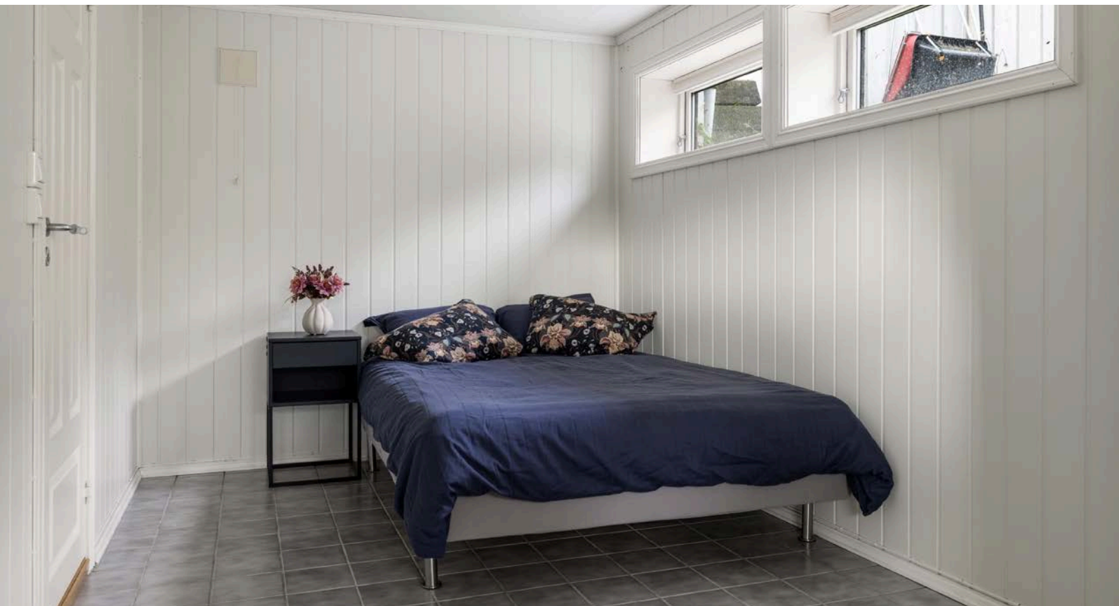
Rom i kjeller som er innredet og brukt som soverom er i byggetegninger registrert som hobbyrom. Det er ikke kjent med at det er søkt bruksendring av rommet. Det har ikke store nok vinduer til at disse gir tilstrekkelig med lysinnslipp.
