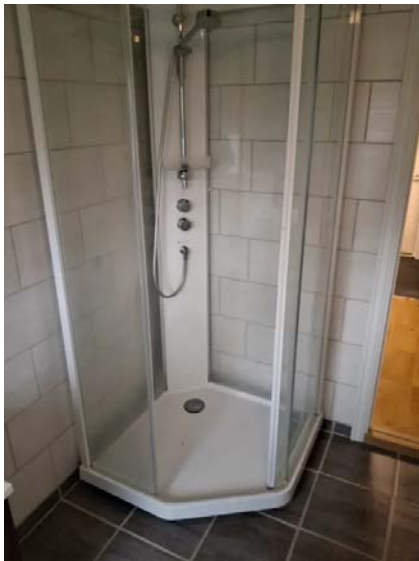
Det er etablert dusjkabinett i våtrommet.
