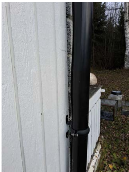
Det registreres buling på nedløpsrør.
