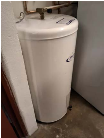
Varmtvannsbereder er plassert i fyrrom.
