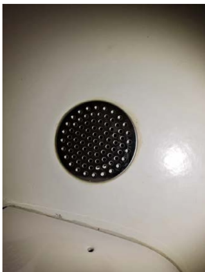
Slukrist til sluk ved servant sitter fast i gulv.
