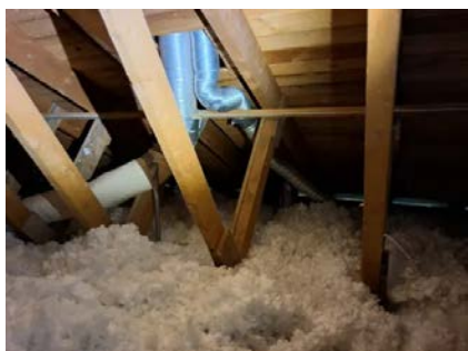
Det registreres uisolerte ventilasjonskanaler.
