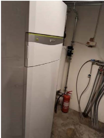
Bergvarmepumpe er plassert i fyrrom.
