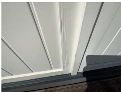
Bilde viser råte i terrassedør 2 etasje.
