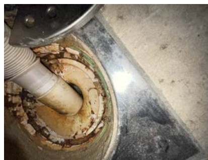
Bilde viser sluk under dusjkabinett. Dusjkabinett er ikke flyttet.
