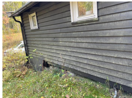
Kan påregnes vedlikehold av fasade.
