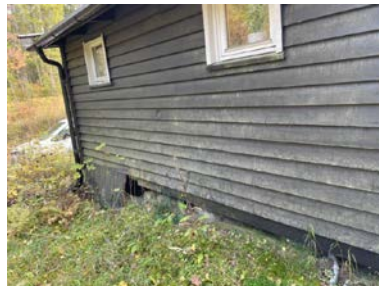
Kan påregnes vedlikehold av fasade.
