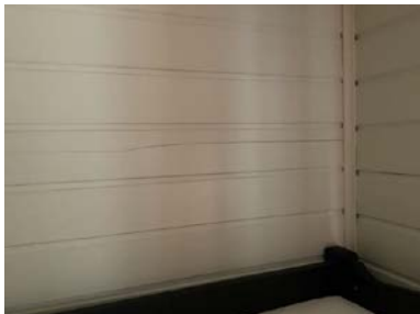
sprekk i panel soverom
