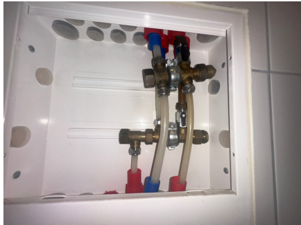
Samleskap med rørkurser og stoppekraner
