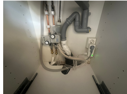
Røropplegg i kjøkkenbenk med Waterguard
