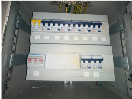
Sikringskap med automatsikringer.
