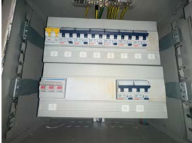
Sikringsskap med automatsikringer.
