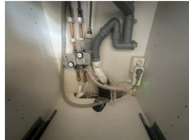
Rørropplegg i kjøkkenbenk med Waterguard
