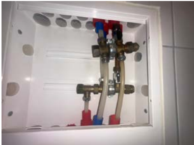
Samleskap med rørkurser og stoppekraner
