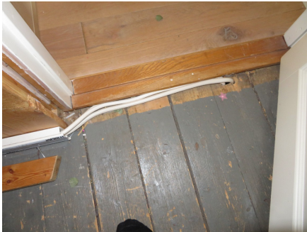
El-ledninger på gulv i bod.
