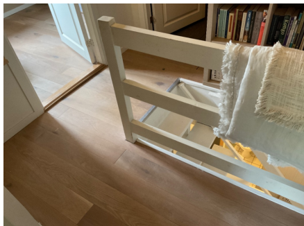
Rekkverk med store åpninger.
