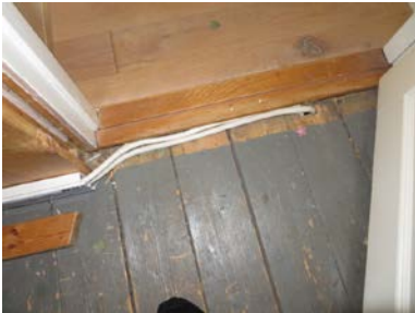
El-ledninger på gulv i bod.
