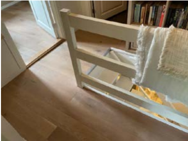
Rekkverk med store åpninger.
