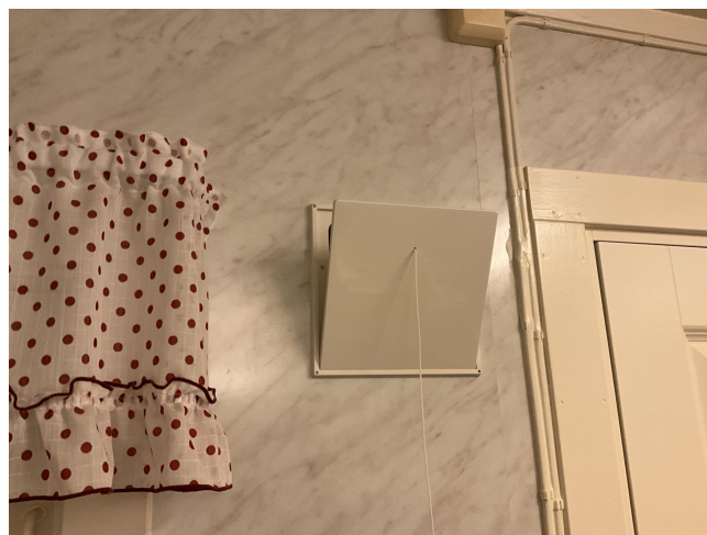
Materialet har passert sin forventede tekniske levetid.
