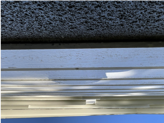
Manglende eller feilmontert luftespalte bak kledningen.
