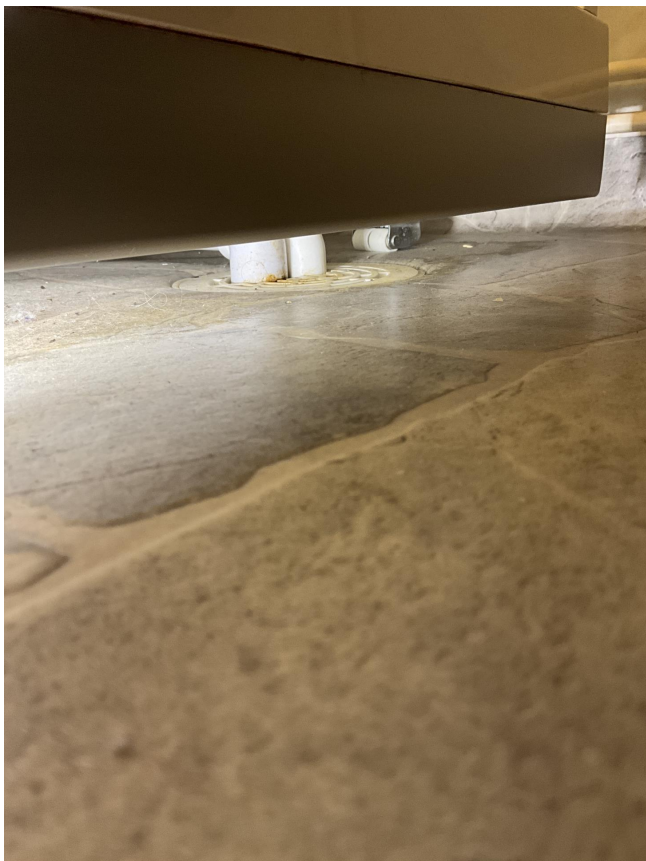
Materialet har passert sin forventede tekniske levetid.
