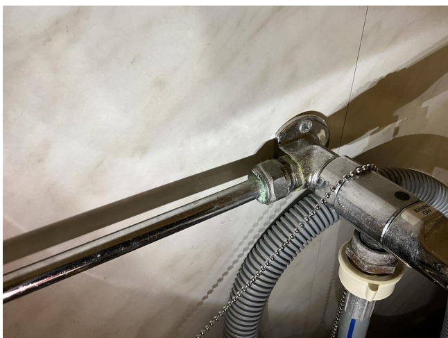
Irr på kobberrør.
