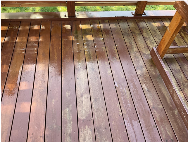
Slitasje på overflatebelegg.
