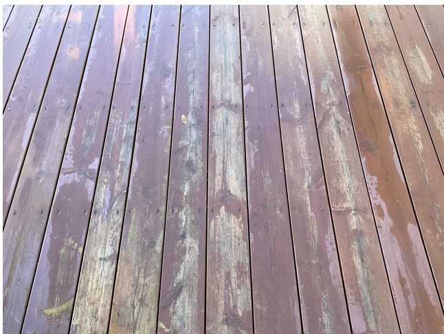
Slitasje på overflatebelegg.
