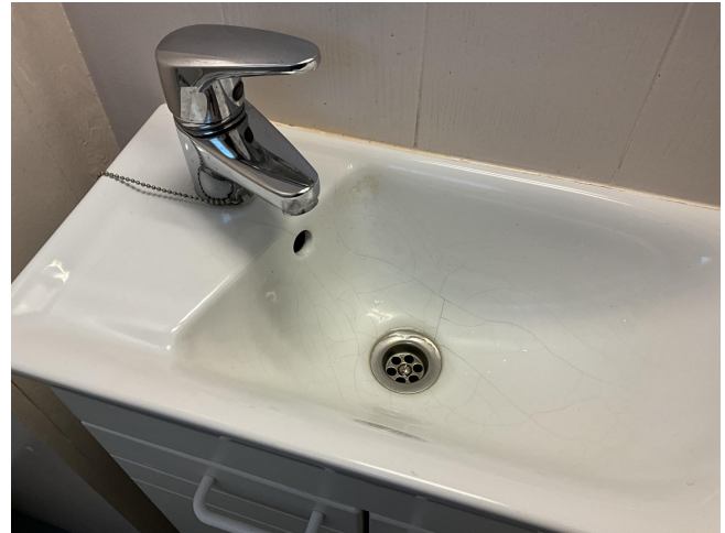
Krakelering i porselenvask.
