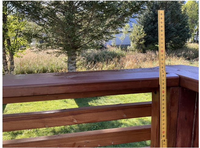
Rekkverk har for lav høyde i forhold til krav for byggeår eller dagens standard.
