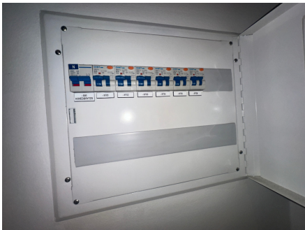
Sikringsskap med automatsikringer.
