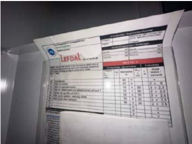
Kursoversikt i sikringsskap
