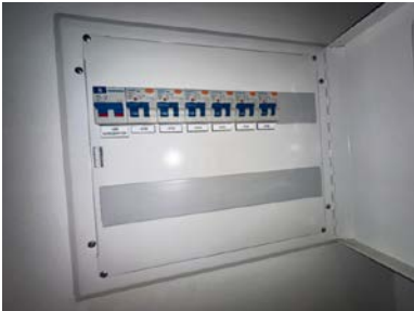
Sikringsskap med automatsikringer.
