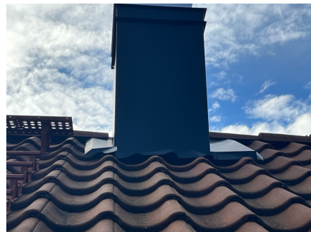
Sokkel beslaget er ikke tilpasset taktekkingen
