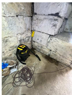
Noe fukt i hjørne mot sørøst i kjelleren.
