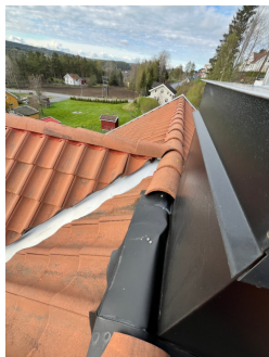
Sokkel beslaget er ikke tilpasset taktekkingen
