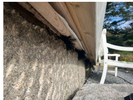
Musebørster er montert, disse bør kontrolleres jevnlig.
