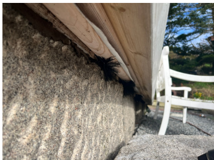
Det er ikke laget lufting i nedkant på vegg på sør og vestvegg.
