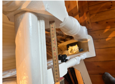
Store åpninger i rekkverket.
