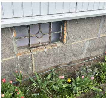
Noe løsnet stein rundt vindu, noen fuger er utbedret.
