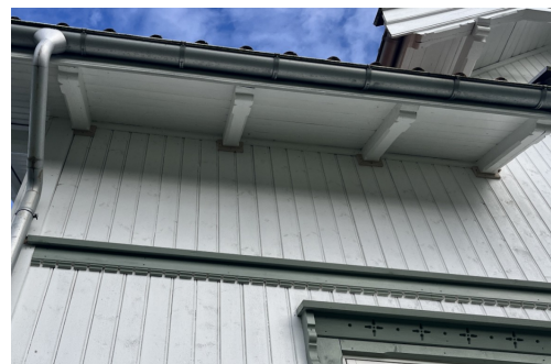
Ingen lufting på rafter.
