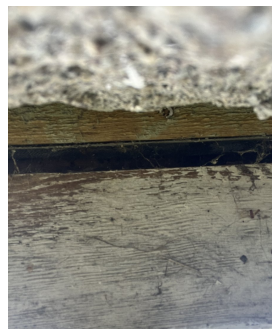
Det mangler musesperre og klelekt på vindsperre i nedkant på nord og østvegg.
