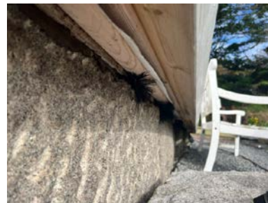
Musebørster er montert, disse bør kontrolleres jevnlig.
