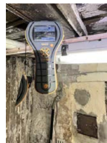
Målt i gulvbjelke midt i kjelleren.
