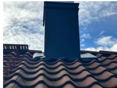
Sokkel beslaget er ikke tilpasset taktekkingen
