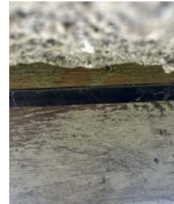
Det mangler musesperre og klemløst på vindsperre i nedkant på nord og østvegg.
