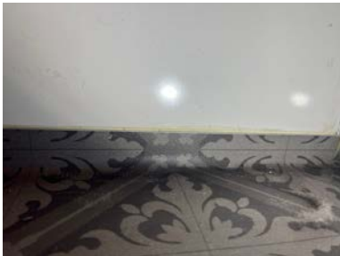
Avstand fra gulv til underkant av veggplate mindre enn 60mm.
