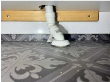
Ikke oppbrett på belegg rundt rør
