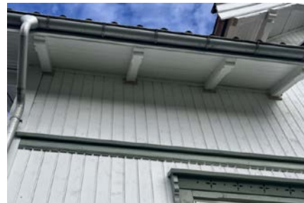
Ingen lufting på rafter.
