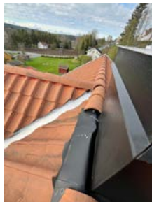
Sokkel beslaget er ikke tilpasset taktekkingen
