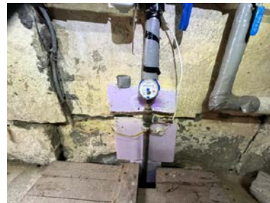
Stoppekran og vannmåler.
