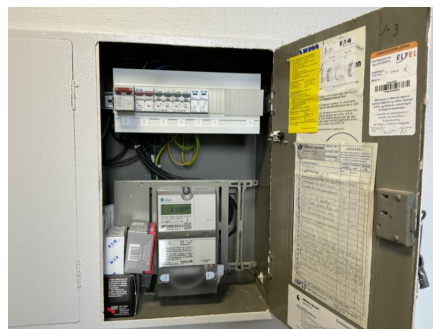
Automatsikringer i sikringsskap plassert i gang/fellesareal.
