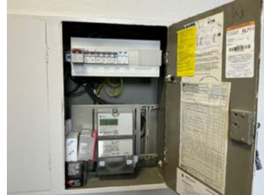
Automatsikringer i sikringsskap plassert i gang/fellesareal.
