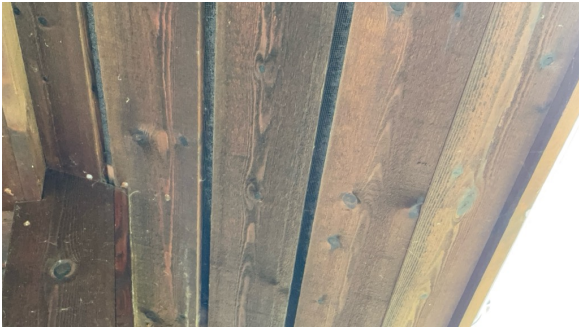
Lufting med netting registrert.
