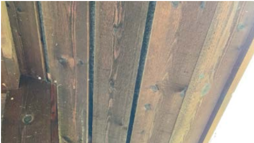
Lufting med netting registrert.
