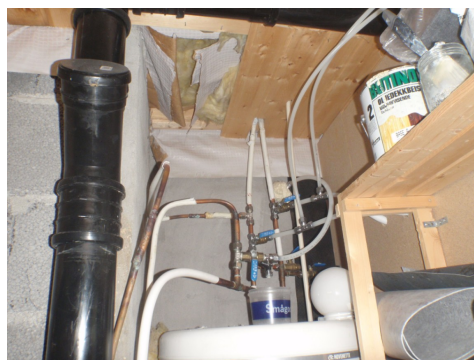
Synlig isolasjon, deler av panel mangler, samt overflatebehandling av veggplater og listverk mangler
