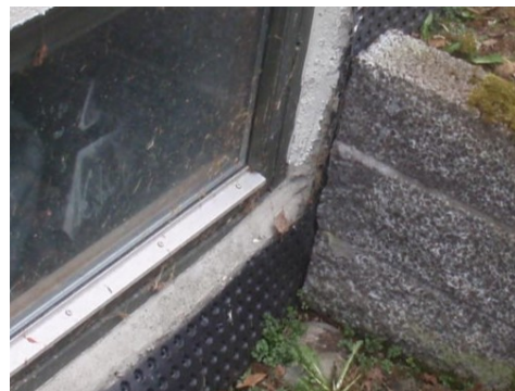
Det mangler beslag under vindu, karm er råte/fuktskadet. Vindu må påregnes utskiftet.
