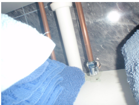
Manglende tetting rundt rørgjennomføringer.
