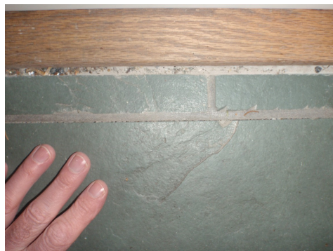
Riss i fuge og bom i fliser.
