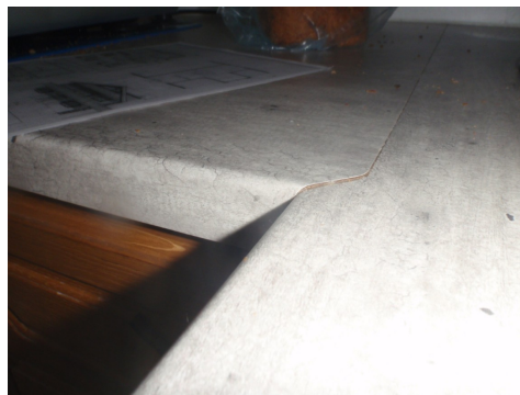
Sprang i skjøt mellom benkeplater, bedre tetting bør utføres.
