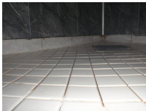
Manglende fugemasse i dusjnise, gjelder fuging mellom fliser på gulv samt silikon i overgang vegg og gulv.
