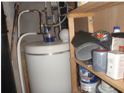
Noe dårlig/begrenset innfesting av vannledninger
