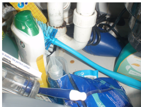
Noe utvelling/fuktmerker i bunnplate.
