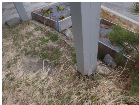
Råteskader i nedkant av flere søyler, søyler er fundamentert på kreosotpilarer (gamle telefonstolper).
