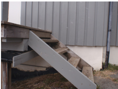
Rekkverk mangler på trapp mot sørøst.
