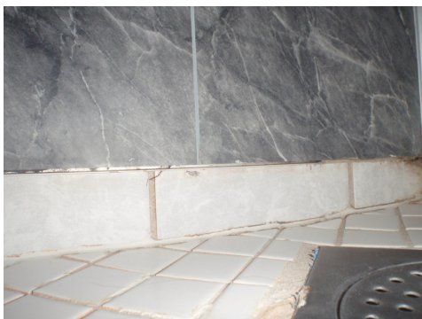
Mangler fugemasse mellom veggplate og bunnlister
