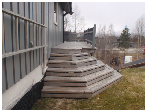
Betydelig skjevheter på balkong, rekkverk og trapp
