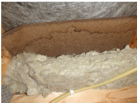
Asfaltplate er presset helt under tro
