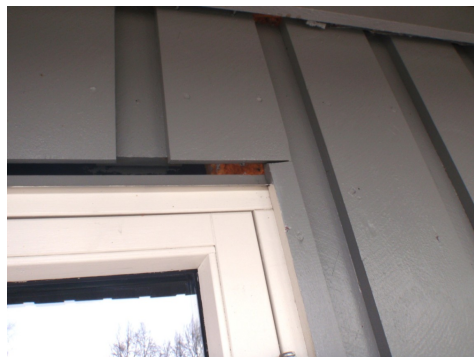
Usikker tetting, synlig skum over beslag.
