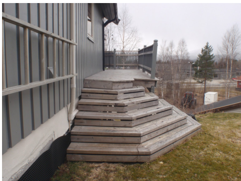
Rekkverk mangler på trapp mot nordvest.
