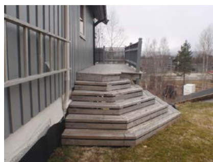
Betydelig skjevheter på balkong, rekkverk og trapp
