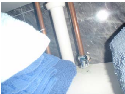
Manglende tetting rundt rørgjennomføringer.
