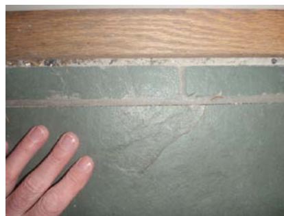
Riss i fuge og bom i fliser.
