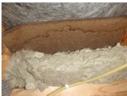
Asfaltplate er presset helt under tro
