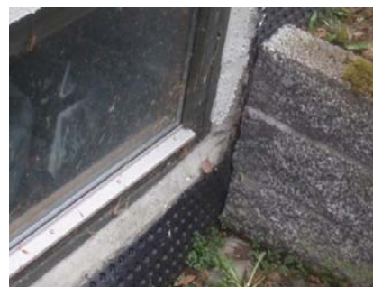
Det mangler beslag under vindu, karm er råte/fuktskadet. Vindu må påregnes utskiftet.
