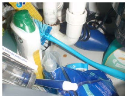
Noe utvelling/fuktmerker i bunnplate.
