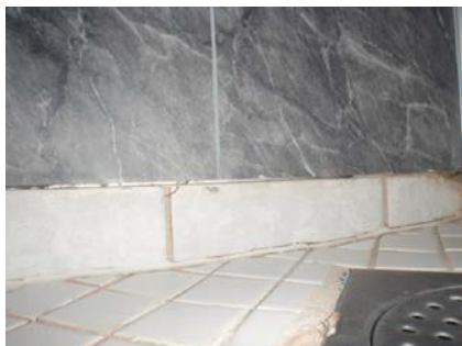
Mangler fugemasse mellom veggplate og bunnlist
