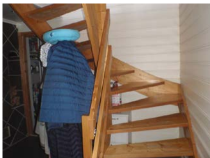
For stor åpning mellom trinn og rekkverk (åpninger skal være mindre enn 10 cm. Det mangler håndløper på vegger
