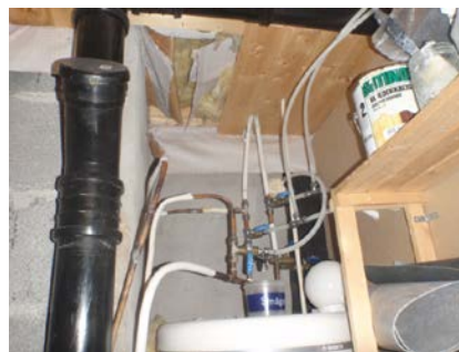
Synlig isolasjon, deler av panel mangler, samt overflatebehandling av veggplater og listverk mangler
