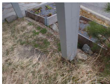
Råteskader i nedkant av flere søyler, søyler er fundamentert på kreosotpilarer (gamle telefonstolper).
