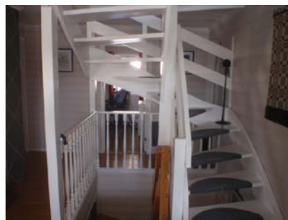
For stor åpning mellom trinn og rekkverk (åpninger skal være mindre enn 10 cm. Det mangler håndløper på vegger
