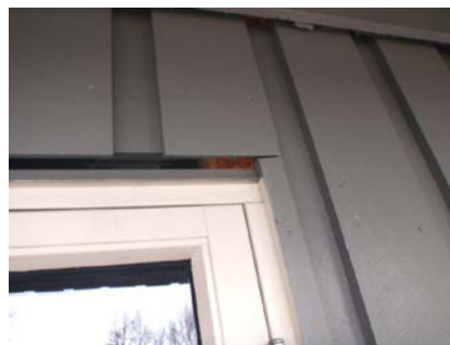
Usikker tetting, synlig skum over beslag.
