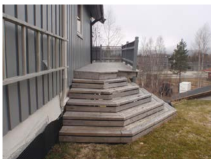
Rekkverk mangler på trapp mot nordvest.
