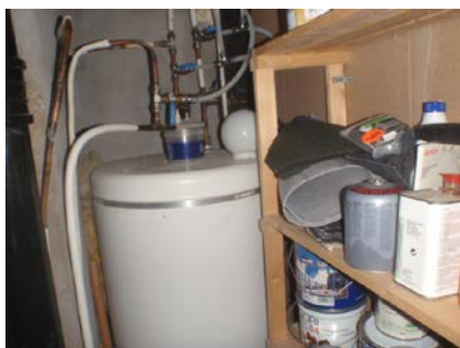
Noe dårlig/begrenset innfesting av vannledninger
