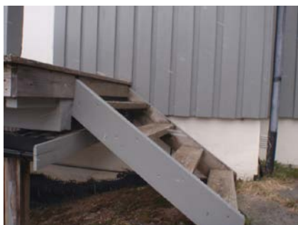
Rekkverk mangler på trapp mot sørøst.
