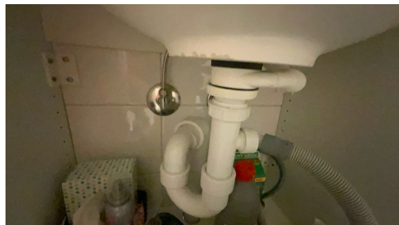
Del av rør til avløp.
