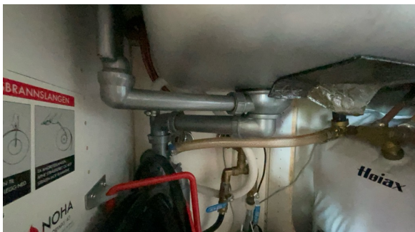
Del av rør til avløp.
