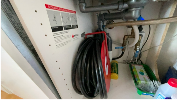
Husbrannslange med vann.
