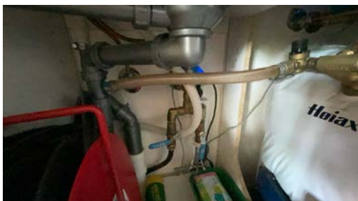
Del av rør til vann.
