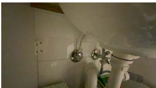
Del av rør til vann.
