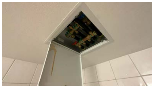
Skap til rør i rør system, her er også stoppekran til vann.
