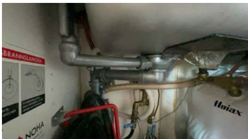
Del av rør til avløp.
