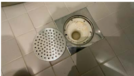
Sluk i gulv.
