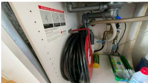
Husbrannslange med vann.
