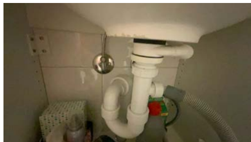
Del av rør til avløp.
