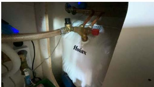
Varmtvannstank i kjøkkenbenk.
