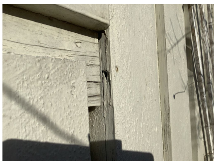
Råte i hjørne mot sør.
