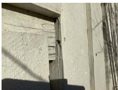
Råte i hjørne mot sør.
