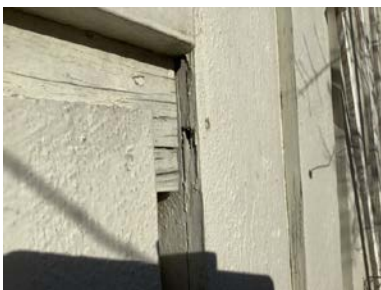
Råte i hjørne mot sør.
