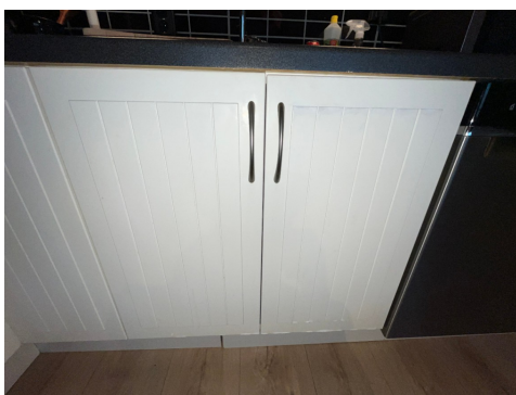
Noe svelling i skap fronter og benkeplate ved vask
