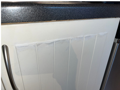
Noe svelling i skap fronter og benkeplate ved vask
