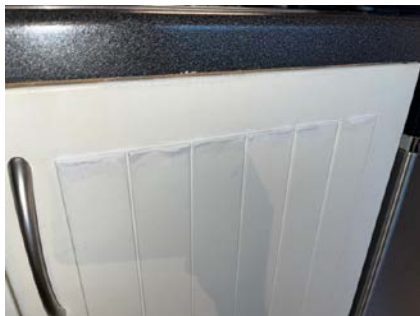
Noe svelling i skap fronter og benkeplate ved vask 11 ETASJE > STUE/KJØKKEN - 26.5M2
