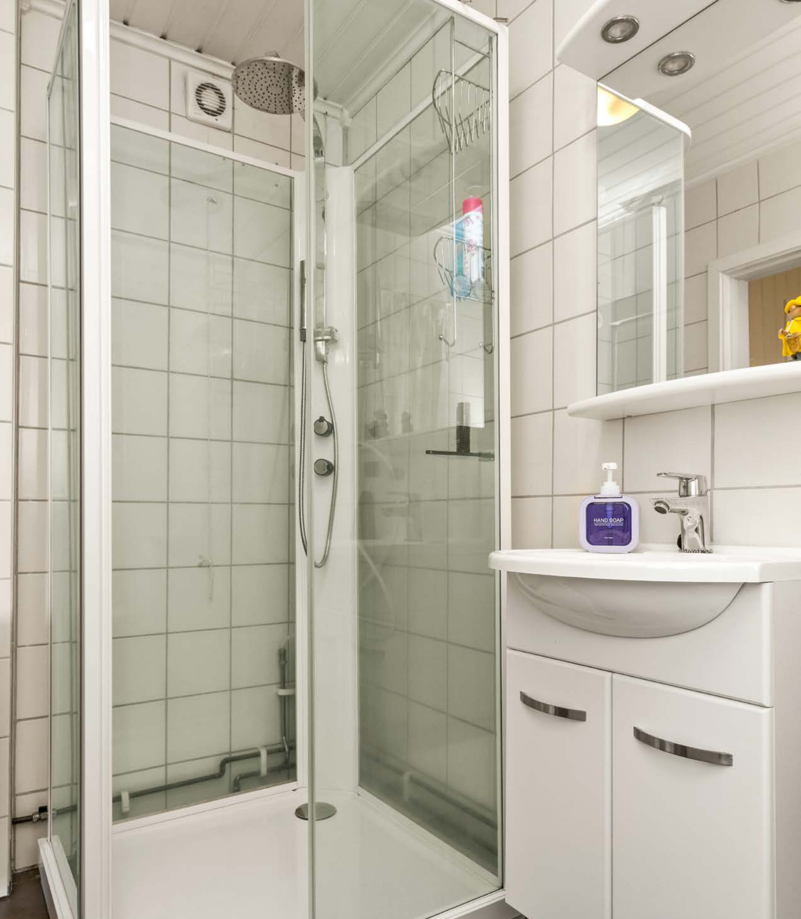
Dusjkabinett på bad
