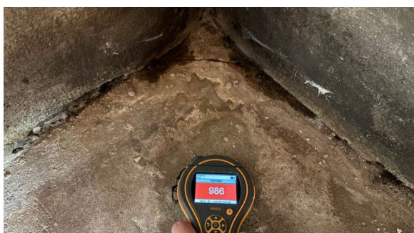
Forhøyde fuktverdier i gulvet flere steder
