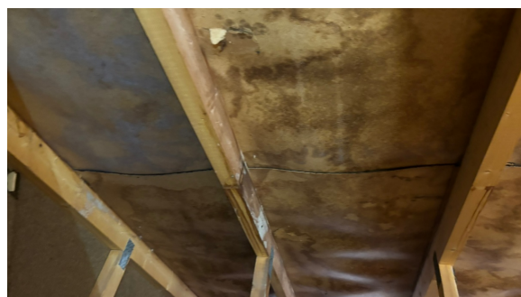
Opprinnelig undertak er preget av større slitasje
