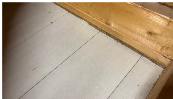
Fuktsperre er punktert flere steder
