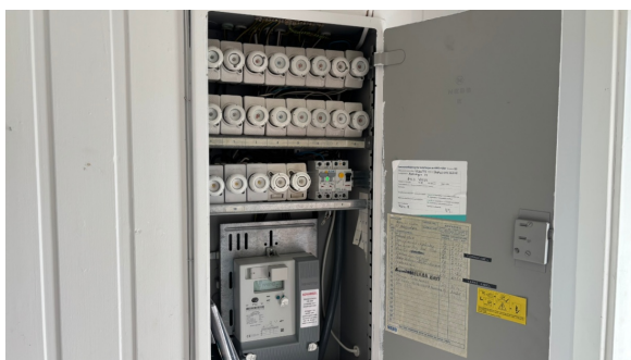
Sikringsskapet er plassert i kjelleren ved hovedinngangen
