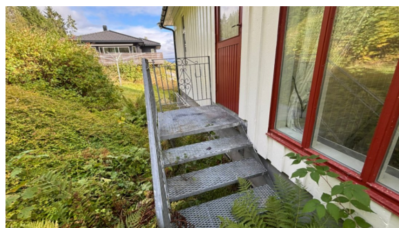
Galvanisert ståltrapp ut fra vaskerommet
