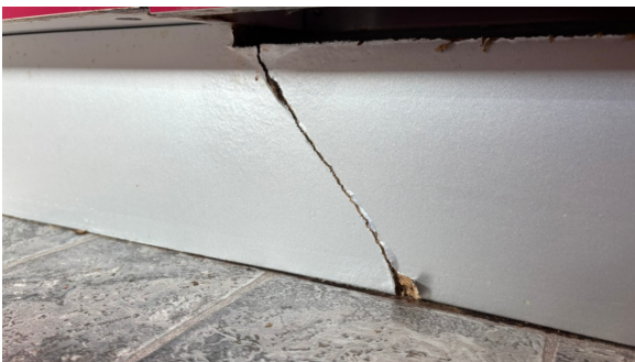
Skade på sokkelen
