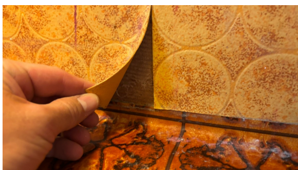
Tapeten har løsnet enkelte steder
