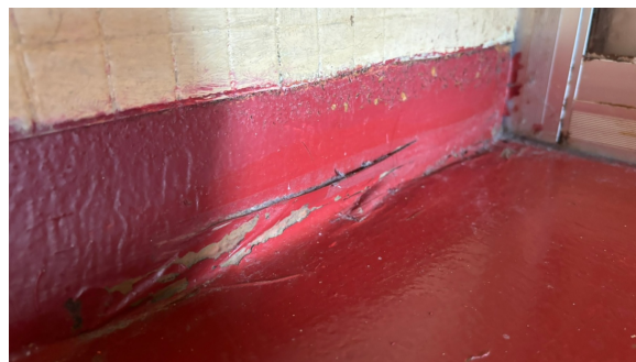
Tettesjiktet har sprukket opp flere steder
