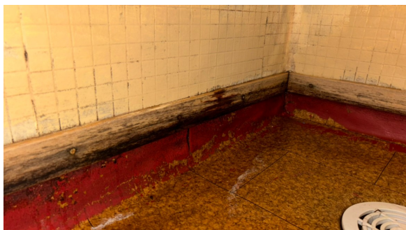
Trelis i dusjnise er fuktskadet
