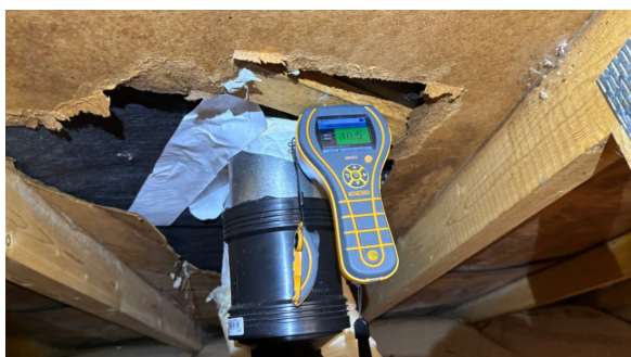
Gjennomføringen fremstår noe utett
