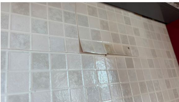
Belegget på vegg er løst noen steder
