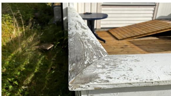
Topprekke er værslitt på vestvendt veranda
