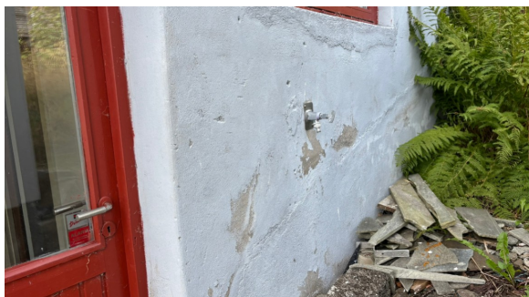
Stedvis noe malingsavskalling
