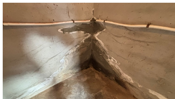
Saltutslag på veggen i boden lengst øst
