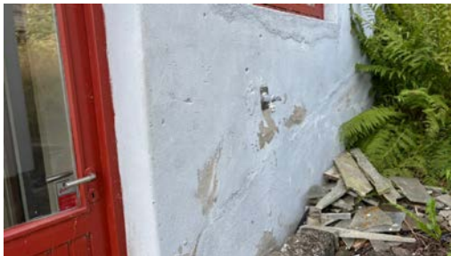
Stedvis noe malingsavskalling
