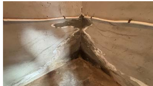
Saltutslag på veggen i boden lengst øst
