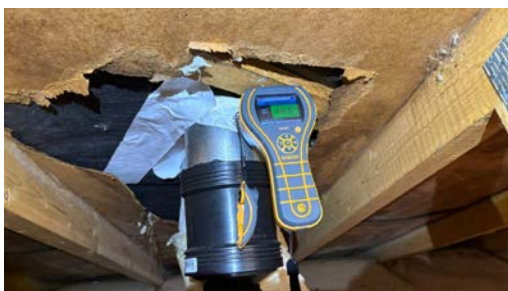
Gjennomføringen fremstår noe utett
