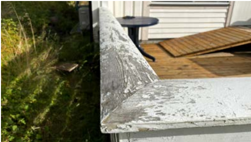
Topprekke er værslitt på vestvendt veranda
