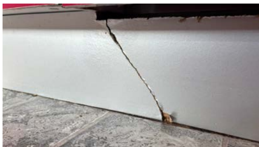
Skade på sokkelen
