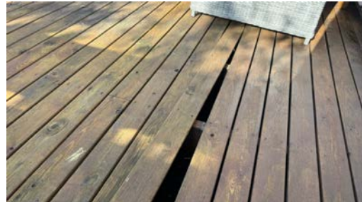
Det er ett løst terrassebord på vestvendt veranda
