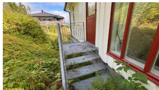
Galvanisert ståltrapp ut fra vaskerommet
