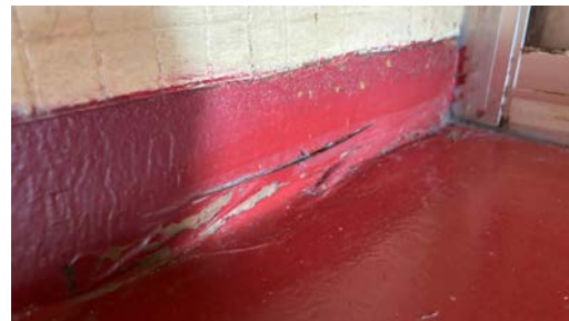
Tettesjiktet har sprukket opp flere steder
