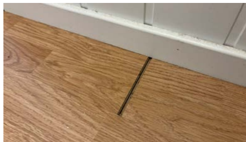
Endeskjøt på laminatgulvet har sklidd fra hverandre.
