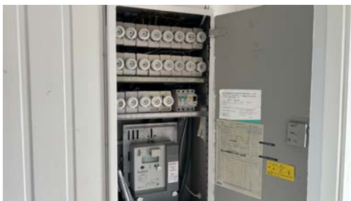
Sikringsskapet er plassert i kjelleren ved hovedinngangen
