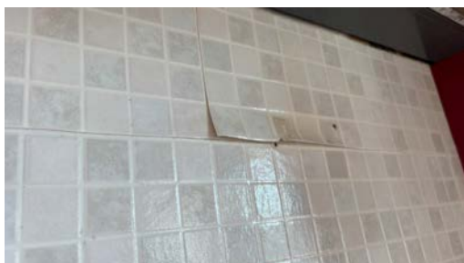
Belegget på vegg er løst noen steder
