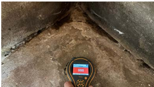
Forhøyde fuktverdier i gulvet flere steder
