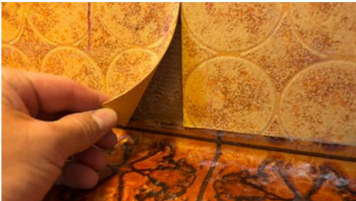
Tapeten har løsnet enkelte steder
