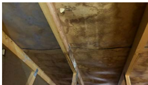
Opprinnelig undertak er preget av større slitasje
