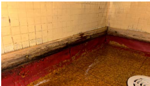
Trelist i dusjnise er fuktskadet
