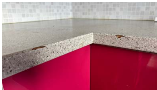
Skader på benkeplaten
