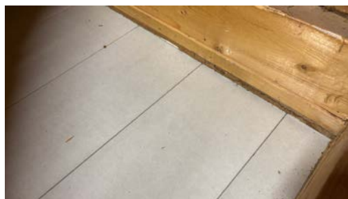
Fuktsperre er punktert flere steder
