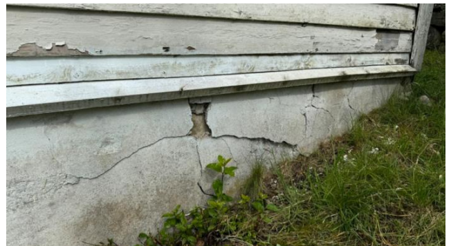
Bilde viser riss og sprekker i grunnmur som bør observeres
