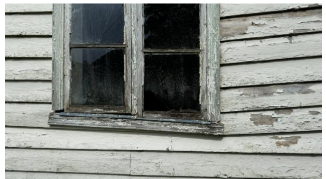
Bilde viser vindu med råteskade og behov for utskifting
