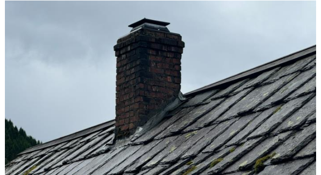
Bilde viser takteking med behov for utskifting, samt eldre slitt skorstein
