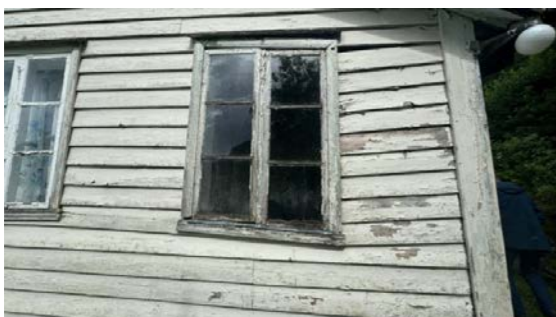
Bilde viser kledning med råteskade og behov for utskifting
