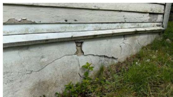
Bilde viser riss og sprekker i grunnmur som bør observeres
