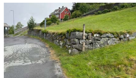
Bilder viser forstøtningsmur med manglende rekkverk/sikring.
