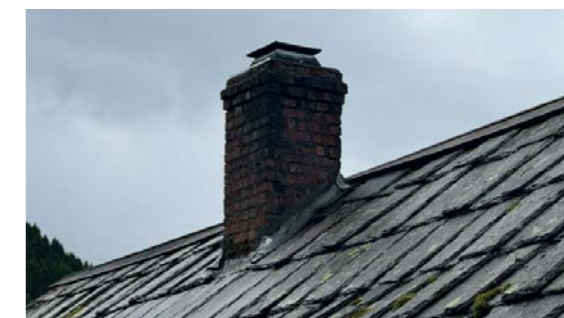
Bilde viser taktekkning med behov for utskifting, samt eldre slitt skorstein
