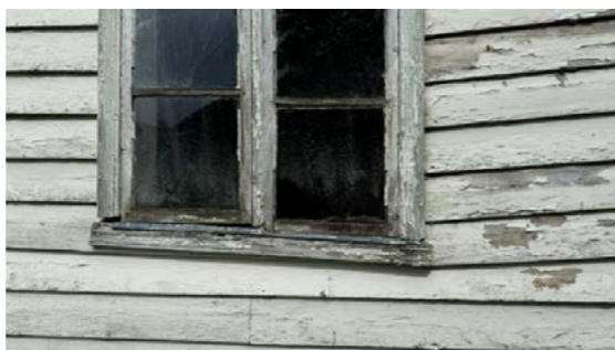
Bilde viser vindu med råteskade og behov for utskifting
