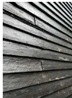
Spredt råteskade og dårlig maling
