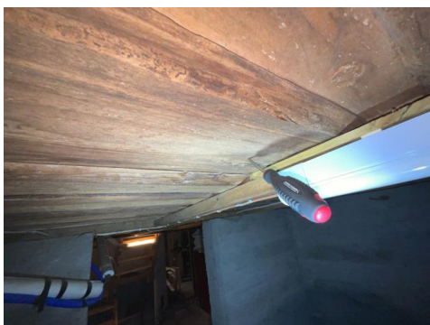
Råte i etasjeskille.
