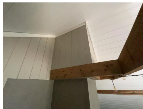
Pipevanger skjult mot takkonstruksjon.
