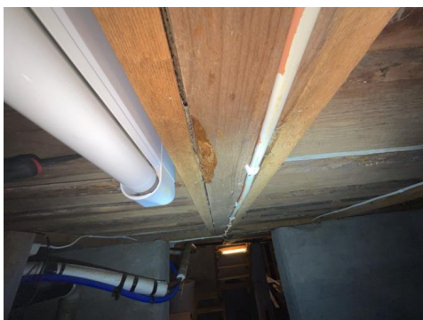
Råte i etasjeskille.
