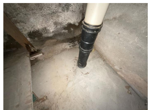
Utsnitt avløpsrør i plast.
