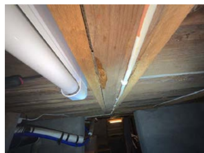
Råte i etasjeskille.
