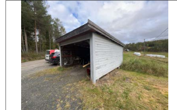
Utsnitt carport. Carport er på 19m 2 . Det er registrert skjevheter i konstruksjonen, carport står for utbedringer og vedlikehold.
