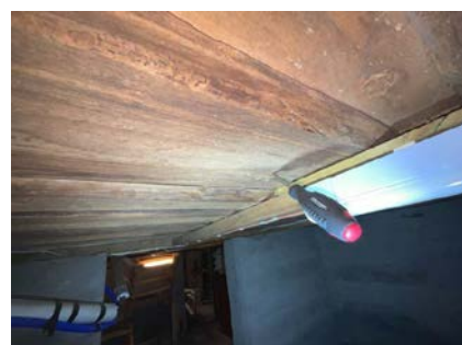
Råte i etasjeskille.
