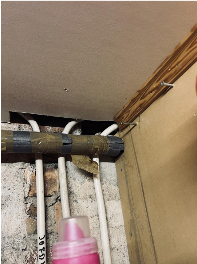
Åpning i vegg i kjeller. Usikker brantetting.
