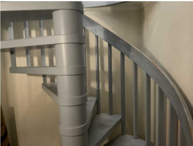
Smal vindeltrapp. Stor åpning mellom trappepenn.
