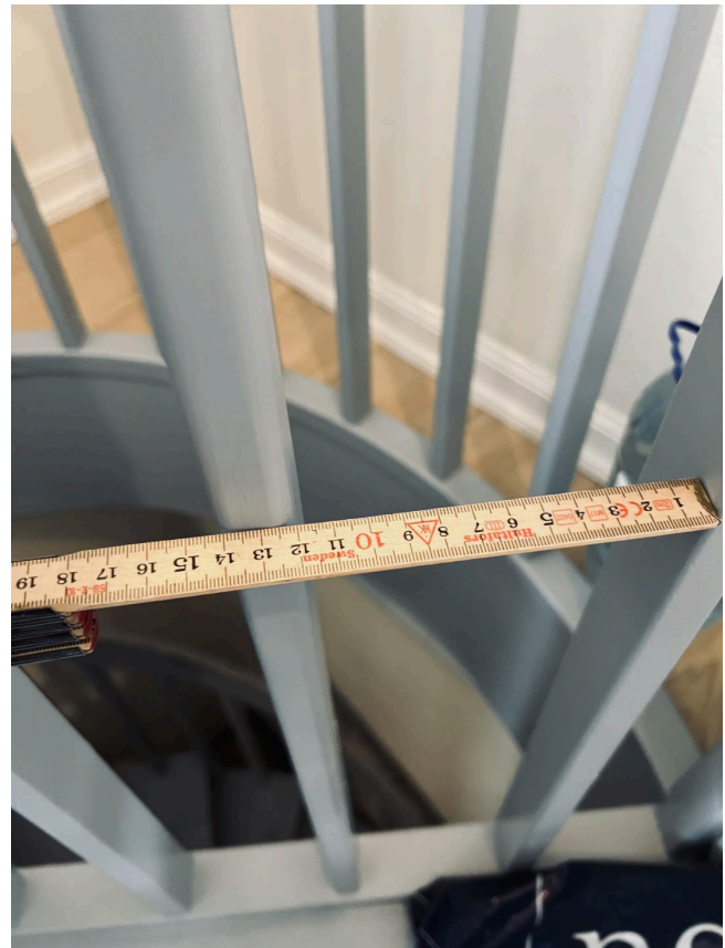
12 cm. åpning i rekkverk. Dette er mer en krav på maks. 10 cm. åpning i et rekkverk.
