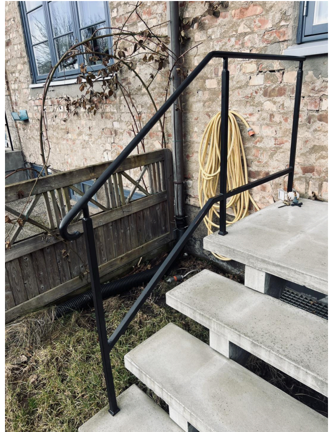
Store åpninger i rekkverk på utvendig trapp.
