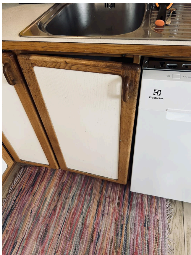
Sterk slitasje på kjøkkeninnredning.
