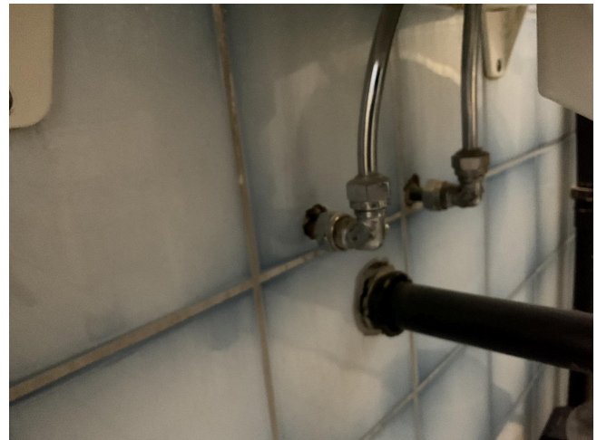
Gamle kobber-rør, ført inne i vegg.
