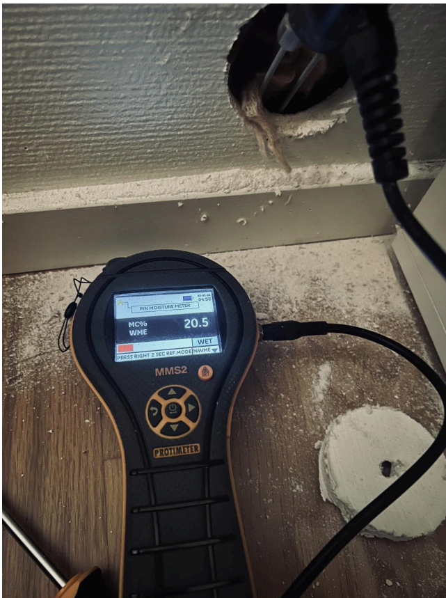
Hulltaking med fuktmåling i yttervegg i soverom i kjeller. Skadelig fukt registrert.
