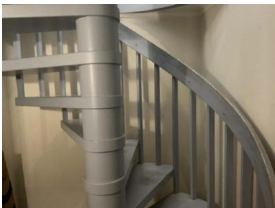
Smal vindeltrapp. Stor åpning mellom trappetrinn.
