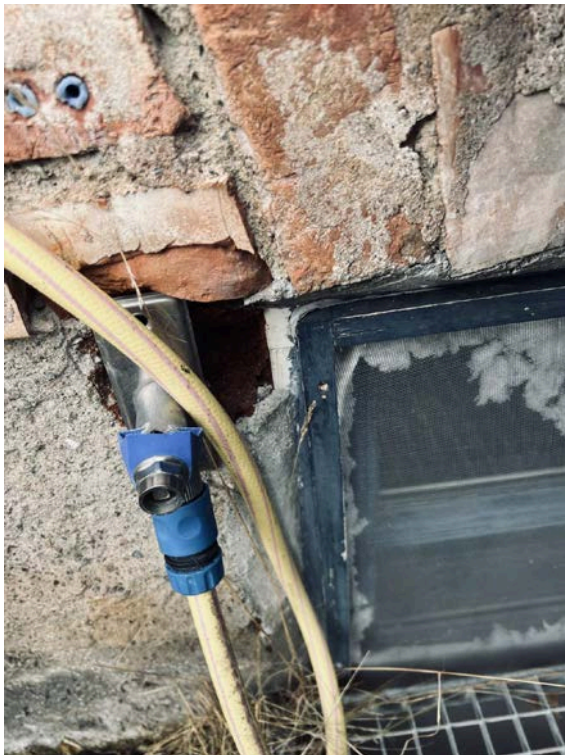
Gjenstående arbeide med gjennomføring for utvendig vannkran.
