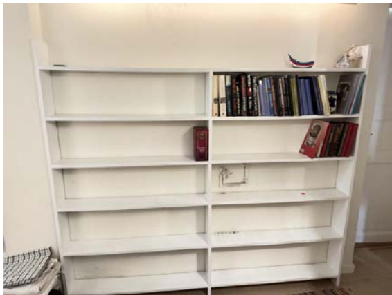
Feieluke i kjeller ved bokhylle. Ikke tilfredsstillende avstand til brennbart materiale.
