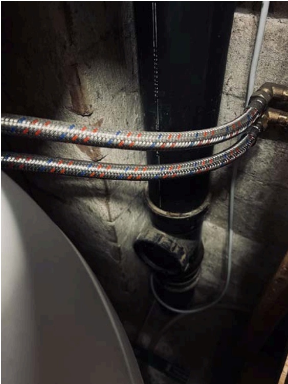
Plast avløps-rør synlig inne i bod.
