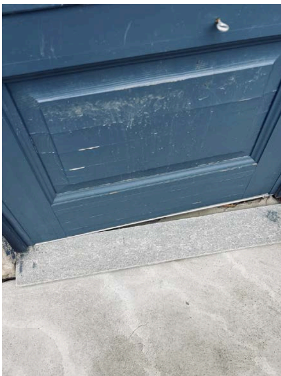
Gjenstående avslutning under terrassedør. Utvendig bruks/værslittasje på døren.
