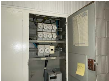
Skrusikringer i sikringsskap plassert i gang/fellesareal.
