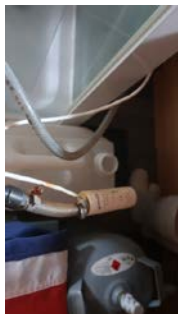
Vannopplegg med kanne og pumpe.
