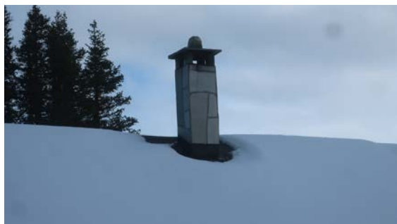
Forblendet pipe over tak.
