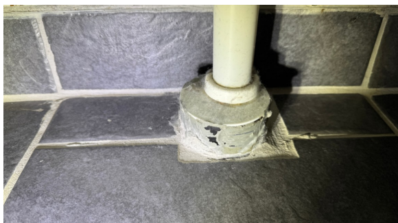
Det er ikke påvist synlig bruk av rørmansjett ved avløp til vasken.
