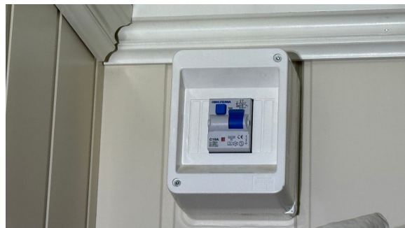
Sikring plassert i skap i gangen.
