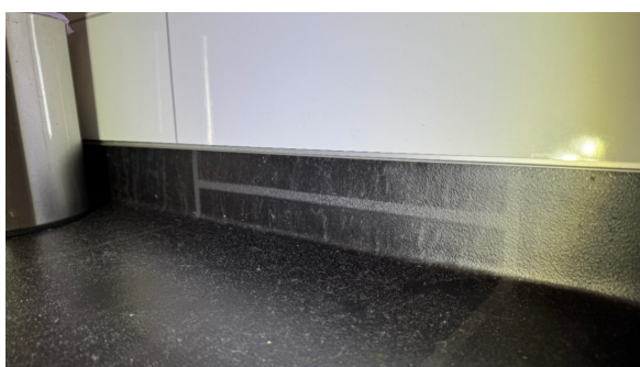
Det er ikke etablert fugemasse mellom bunnlist og baderomsplater.
