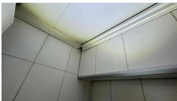
Innkassing av rør er løs.
