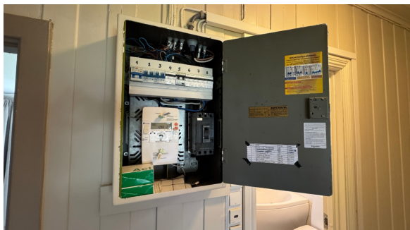
Kontroll av el-skap og kursfortegnelse.
