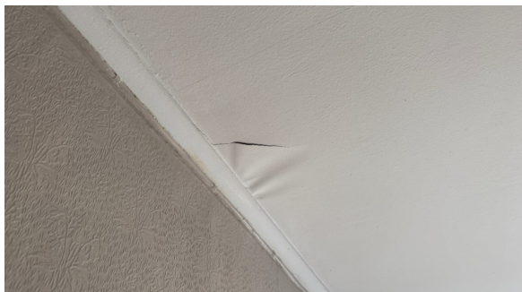
Skade/merker i tak.
