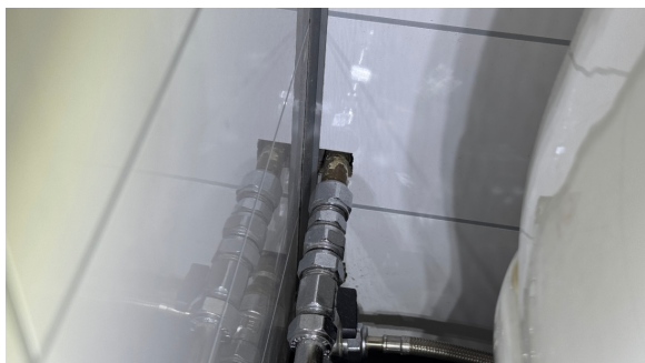
Det er påvist utette rørgjennomføringer i våtsone.
