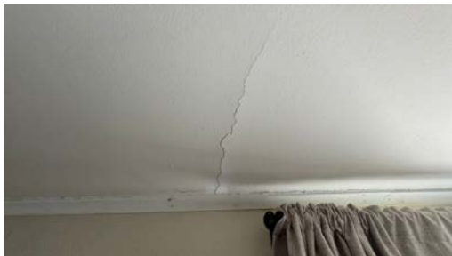
Skade/merker i tak.
