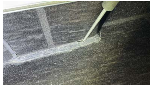
Det er påvist sprekker i fug/overgang mellom vegg/gulv.
