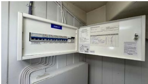
Kontroll av el-skap
