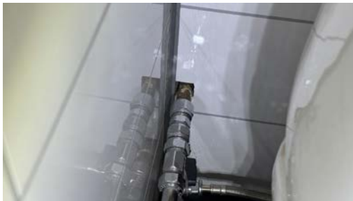
Det er påvist utette rørgjennomføringer i våtsone.
