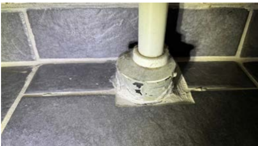
Det er ikke påvist synlig bruk av rørmansjett ved avløp til vasken.
