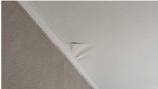
Skade/merker i tak.
