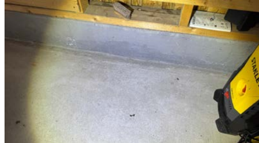
Eier opplyser at det ved noen tilfeller ved nedbør kommer noe fuktmerker på betonggulvet i sportsboden.
