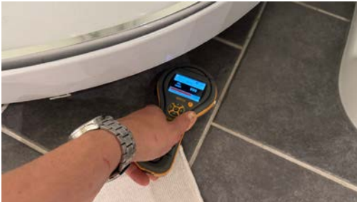
Det ble fuktmålt ved befaring og forhøyede fuktverdier ble registrert.
