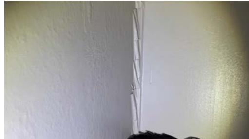
Skade/merker i tapet.
