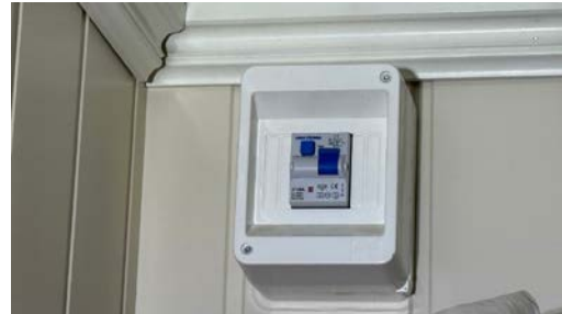
Sikring plassert i skap i gangen.
