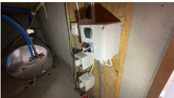
Kontrollpanel og alarm pumpe.
