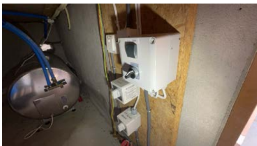
Kontrollpanel og alarm pumpe.
