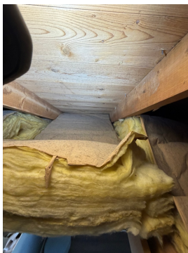
Manglende lufting langs raft/over yttervegg
