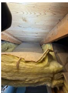
Manglende lufting langs raft/over yttervegg
