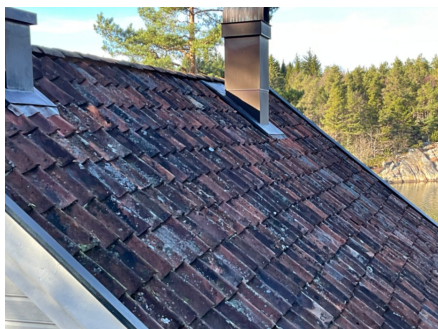
Mangler flere stein på taket.
