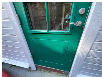
Skader rundt glasset.
