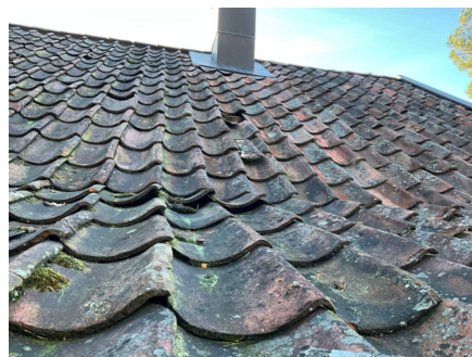
Vått på undertaket.
