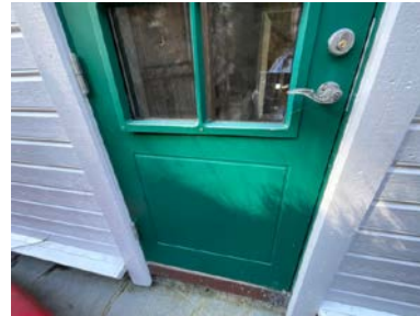
Skader rundt glasset.
