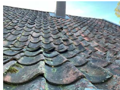
Vått på undertaket.
