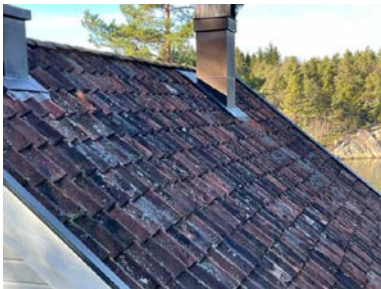
Mangler flere stein på taket.
